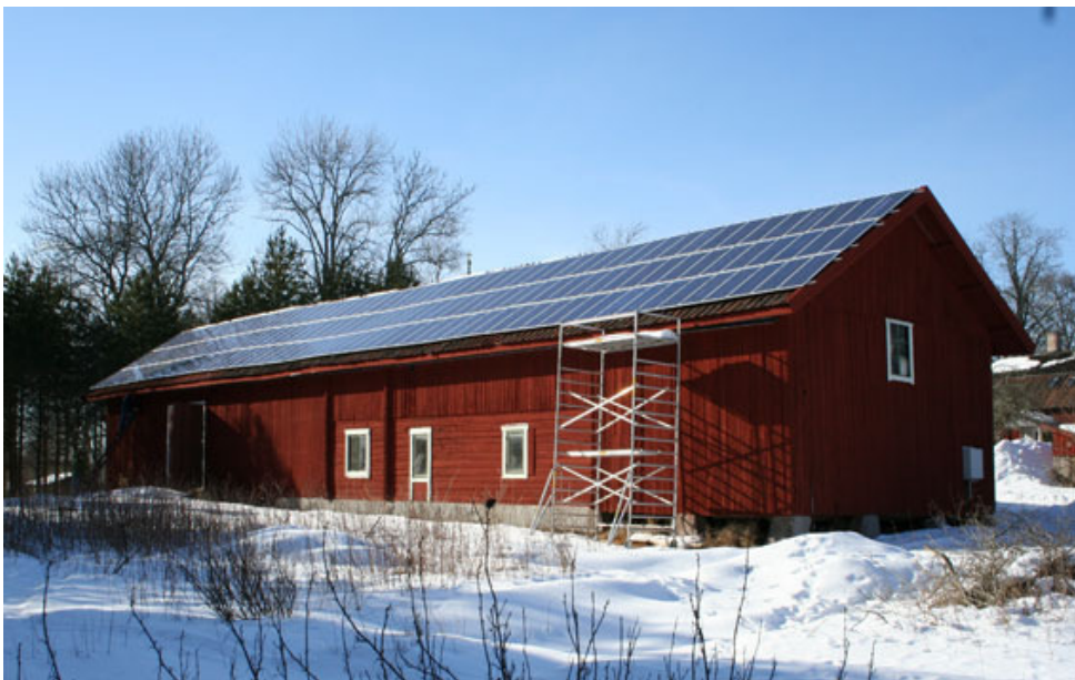
Solelpaneler på uthus vid kyrkan i Fläckebo, www.switchpower.eu
